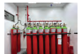
ระบบดับเพลิงอัตโนมัติ NOVEC 1230
